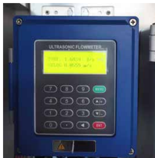
Misuratore di portata
