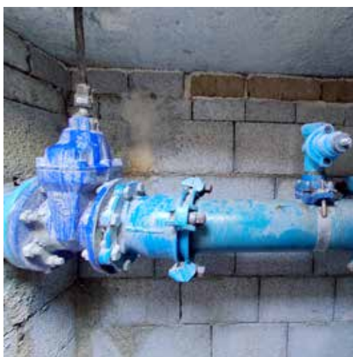
Particolare scatola FCM
