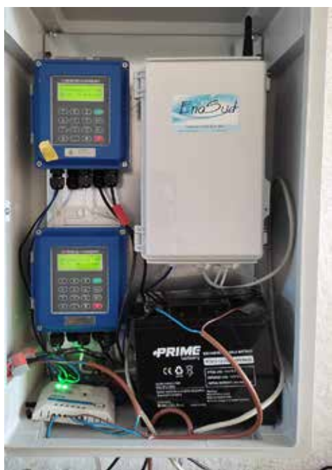
2 Sistema FCS composto da 2 misuratori di portata, 2 misura- tori di pressione e idrovalvola
